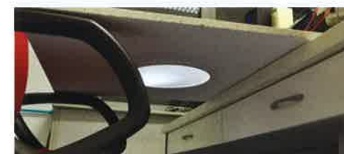
1. ábra. A gipszkarton álmennyezet elemekre, a korábbi süllyesztett mélyszugárzó kompaktfénycsöves lámpatestek kiváltására alkalmazott, ultravékony, kör alakú LED-es világítótest a termikus mérőállomásunkhoz csatlakoztatva
